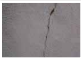
ひび割れが目立ってきたお家
